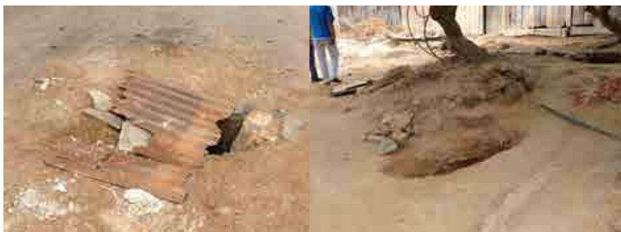
Excavaciones: una protegida con tejas en mal estado la otra sin protección, peligro latente para los transeúntes.
